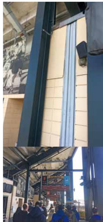
AT & Tパーク接合部 増設工事では既存の建物とのつなぎ目にクリアランスを設けて地震対策を行った。
